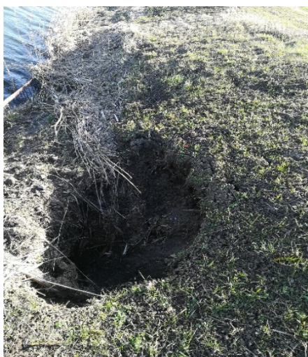
Zdjęcie nr 1 Uszkodzony wał przeciwpowodziowy rzeki Wisły Królewieckiej w wyniku wydrążenia nory przez bobra
