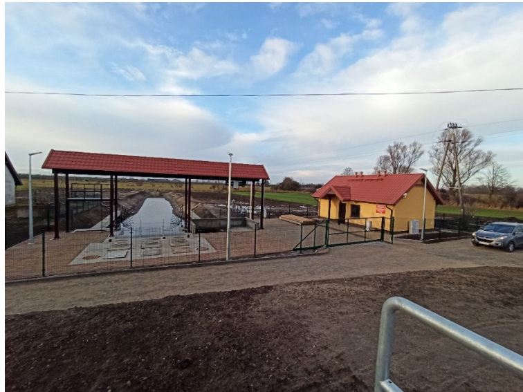
Zdjęcie nr 9 Stacja pomp nr 7 Koszwały
